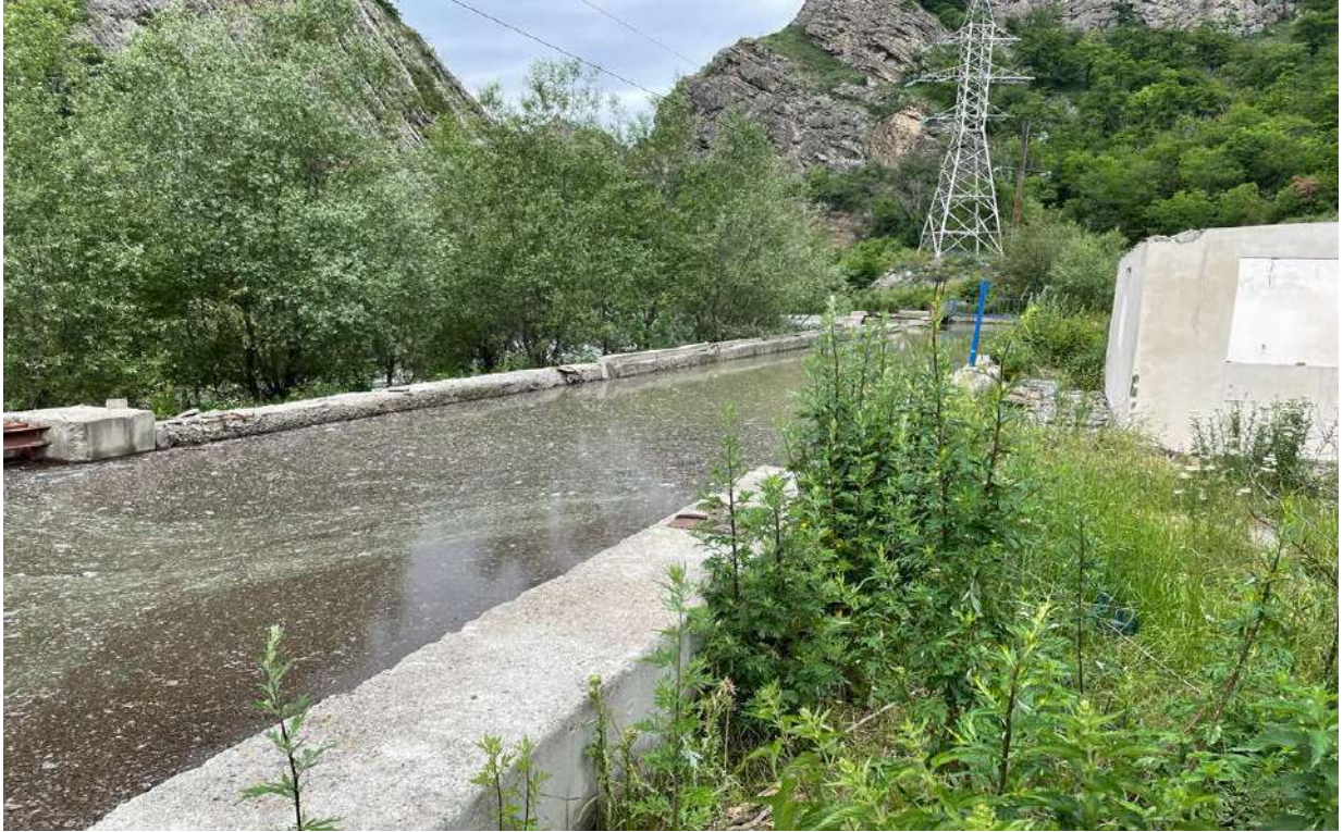
Şəkil 1 Mirik Kiçik Su Elektrik Stansiyasının durulducusunun ümumi görünüşü
