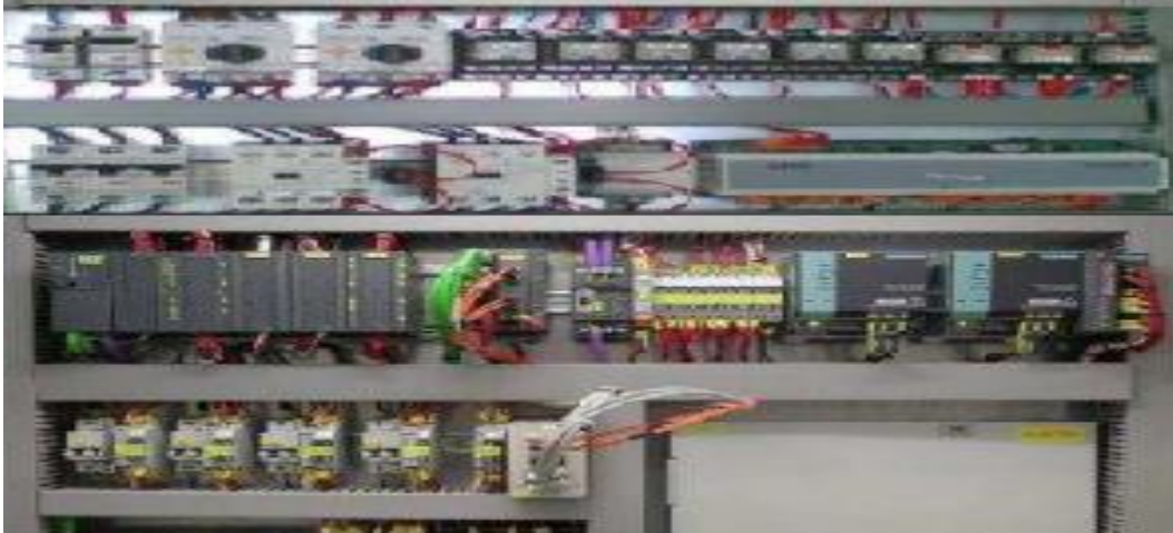
Şekil 5. Oluşturulan güç trafo kontrol paneli
