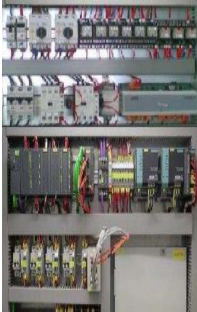
Şekil 5. Oluşturulan güç trafo kontrol paneli
