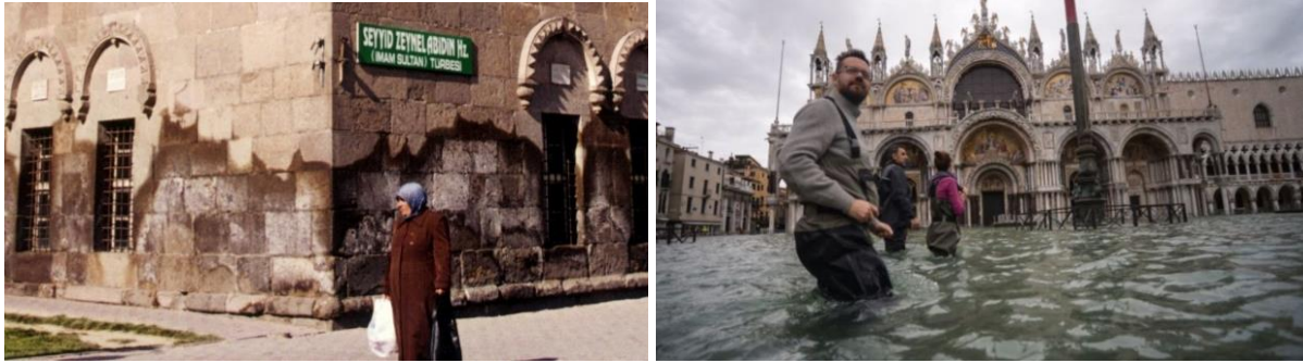
Şekil 1- Kayseri Zeynel Abidin Türbesinde zeminden kapilarite yolu ile yükselen nem ve tuz problemi (H. Kozlu arşivi), Şekil 2- Sel Taşkını (URL 1)
