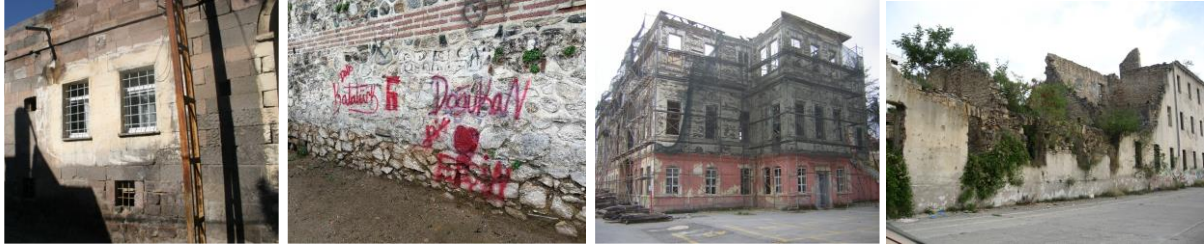
İnsanların Neden Olduğu Kirlilikler (Şekil 3- Bakım/Onarım (H. Kozlu arşivi), Şekil 4- Graffiti (Kaçmaz, 2020), Şekil 5, 6- Yangın, Savaş (Yüzer N., Ekşi Akbulut Ders Notları)
