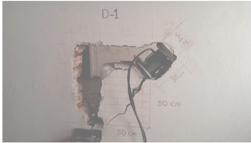
Şekil 2. Bina yükünü ihmal eden tek mesnetli kombine yük altında duvar göçme şekli
